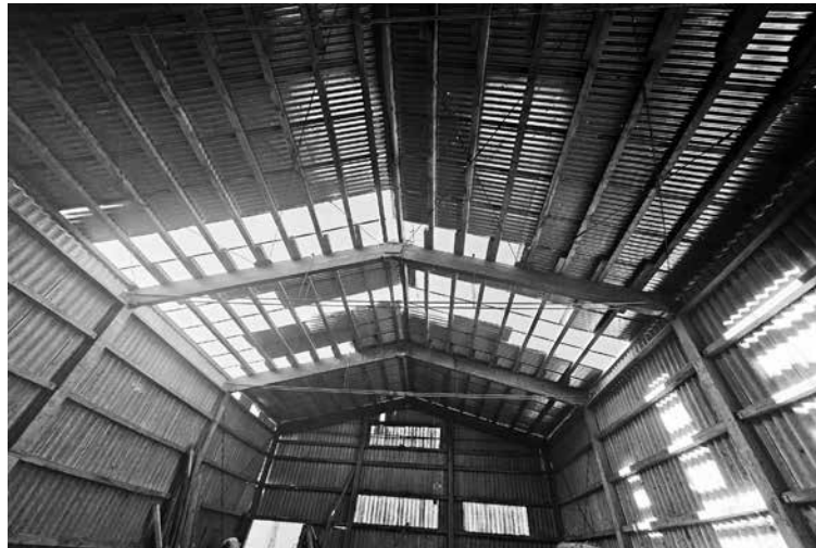
OBČINA KOBARID POZIVA OBČANE K PREVIDNEMU RAVNANJU S POŠKODOVANO AZBESTCEMENTNO KRITINO zaradi orkanskega vetra, pri čemer bo stroške odlaganja v celoti kriila občina. Foto: Občinski štab CZ Občine Kobarid
