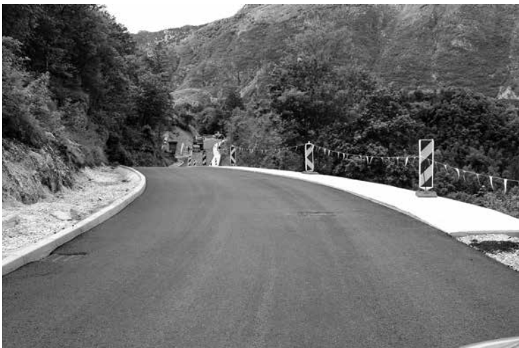
PROJEKT IZGRADNJA GOSPODARSKE JAVNE INFRASTRUKTURE VODENCA VKLJUČUJE IZGRADNJO NOVEGA VODOVODA IN FEKALNE KANALIZACIJE TER OBNOVO CESTE z odvodnjavanjem, pločnikom, javno razsvetlavo in kolesarsko potjo, dela v vrednosti skoraj 1,6 milijona evrov pa naj bi bila zaključena jeseni.
