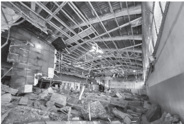
POŽAR, KI JE DECEMBRA ZARADI NAPAKE NA ELEKTRIČNI NAPELJAVI IZBRUHNIL V TELOVADNICI OŠ DUŠANA MUNIHA MOST NA SOČI, JE POVZROČIL PRIBLIŽNO 850.000 EVROV ŠKODE. Poškodovanih k sreči ni bilo, sanacija objekta pa se je začela marca – s ciljem, da bo telovadnica do začetka šolskega leta 2026/2027 ponovno pripravljena za uporabo. Foto: Mojca Kragelj
