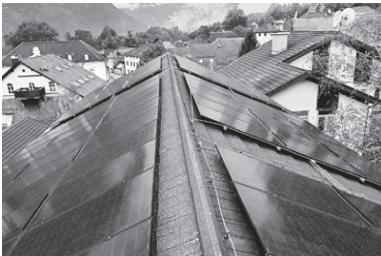
OBČINA BOVEC JE NA STREHI OŠ BOVEC POSTAVILA SONČNO ELEKTRARNO , ki deluje po sistemu skupnostne samooskrbe za OŠ Bovec, Strgulčevo hišo in kulturni dom, s čimer zmanjšuje stroške, povečuje zanesljivost oskrbe in spodbuja uporabo obnovljive energije. Foto: arhiv podjetja Elektro Primorska
